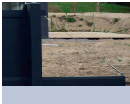
Le câble de tension
